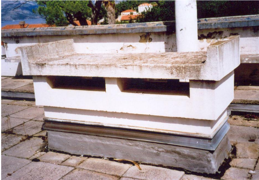
Ventilacioni otvori koje treba ukloniti
