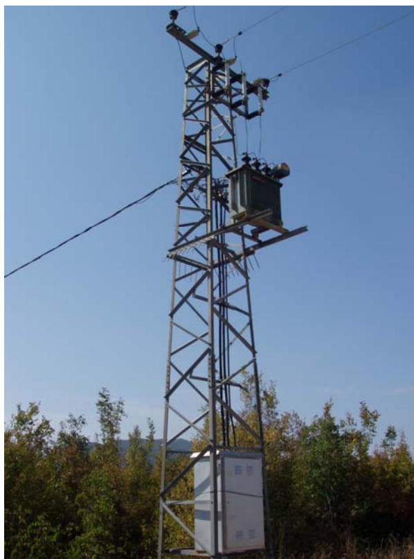
Stupna trafostanica Rastočići
