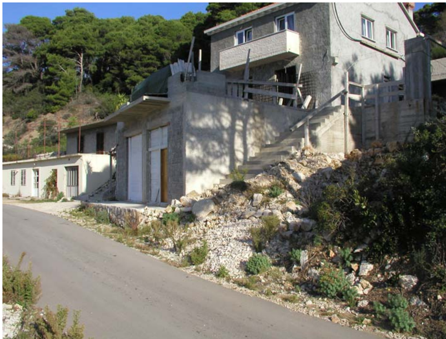
Slika 2-2: Saplunara i njena današnja izgradnja. Nužna je sanacija i konsolidacija načina izgradnje.
