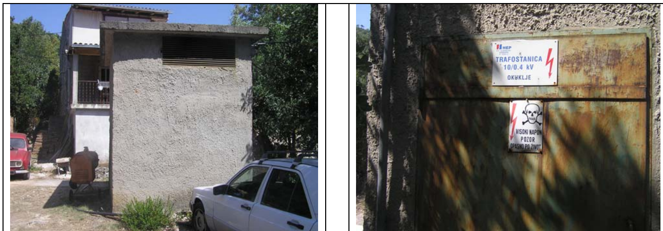
Slika 3-5. Transformatorska stanica pri ulazu u naselje Okuklje.
