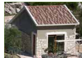
Primjeri pogrešnog oblaganja pročelja tankim kamenim pločama
