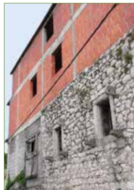
Loš primjer nadogradnje stare kuće
