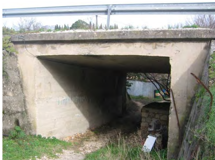
Neuređeni pothodnik ispod državne ceste D-8
